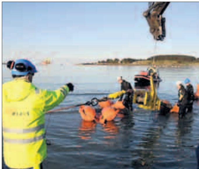
KONTAKT 2: Valhall-feltets 24 mil lange likestraumskabel blei i vår trekt i land til omformarstasjonen på Lista.
